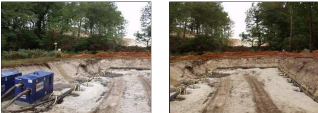
Figure 51 : Pompes et aiguilles filtrantes
